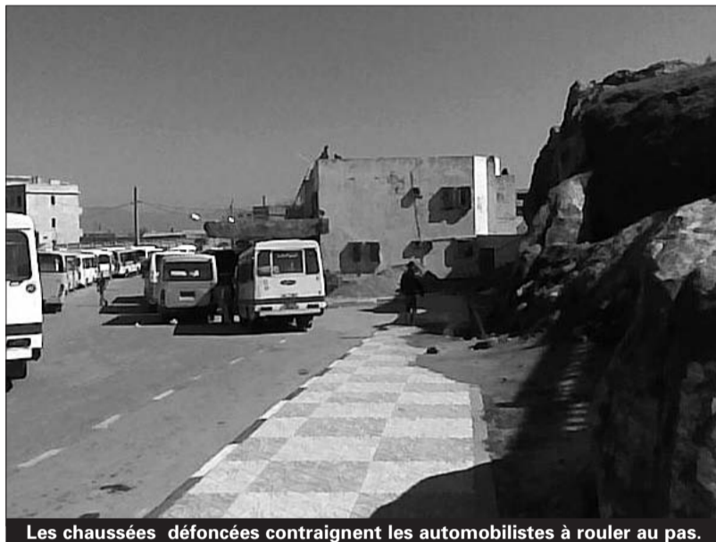
Les chaussées défoncées contraignent les automobilistes à rouler au pas.
