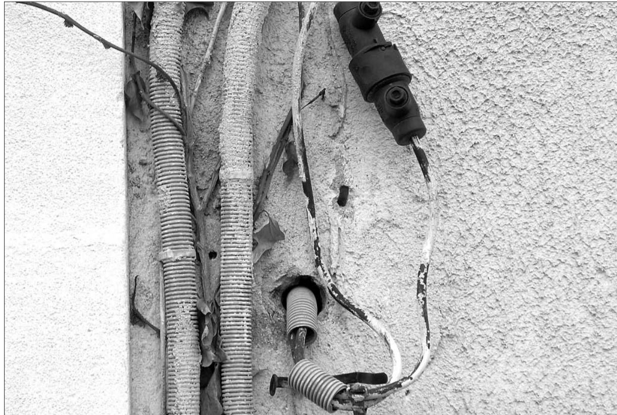
Des branchements improbables mettant en péril la vie des riverains.
