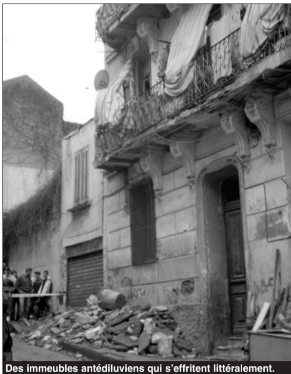
Des immeubles antédiluviens qui s'effritent littéralement.
