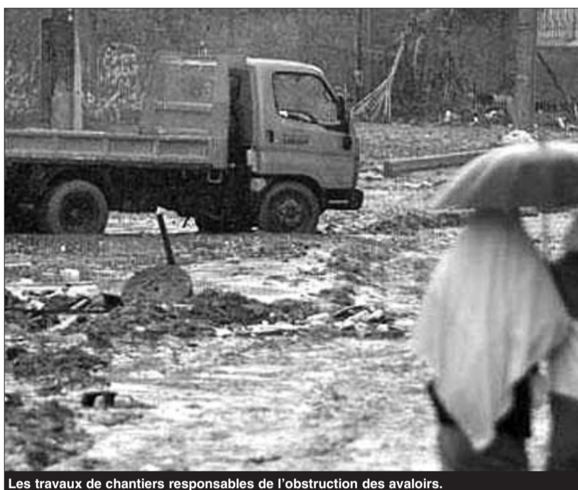
Les travaux de chantiers responsables de l'obstruction des avaloirs.
