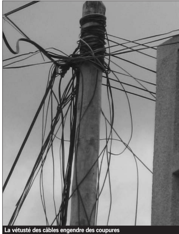
La vétusté des câbles engendre des coupures
