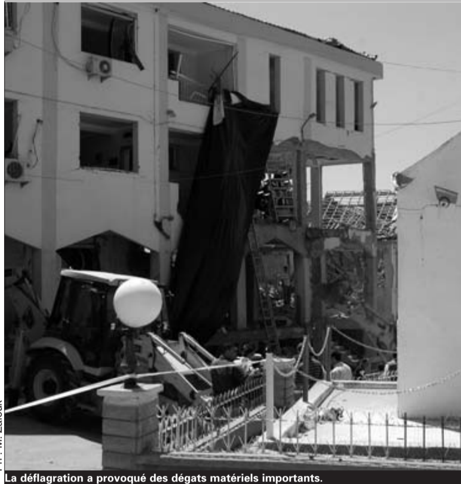
La déflagration a provoqué des dégâts matériels importants.
